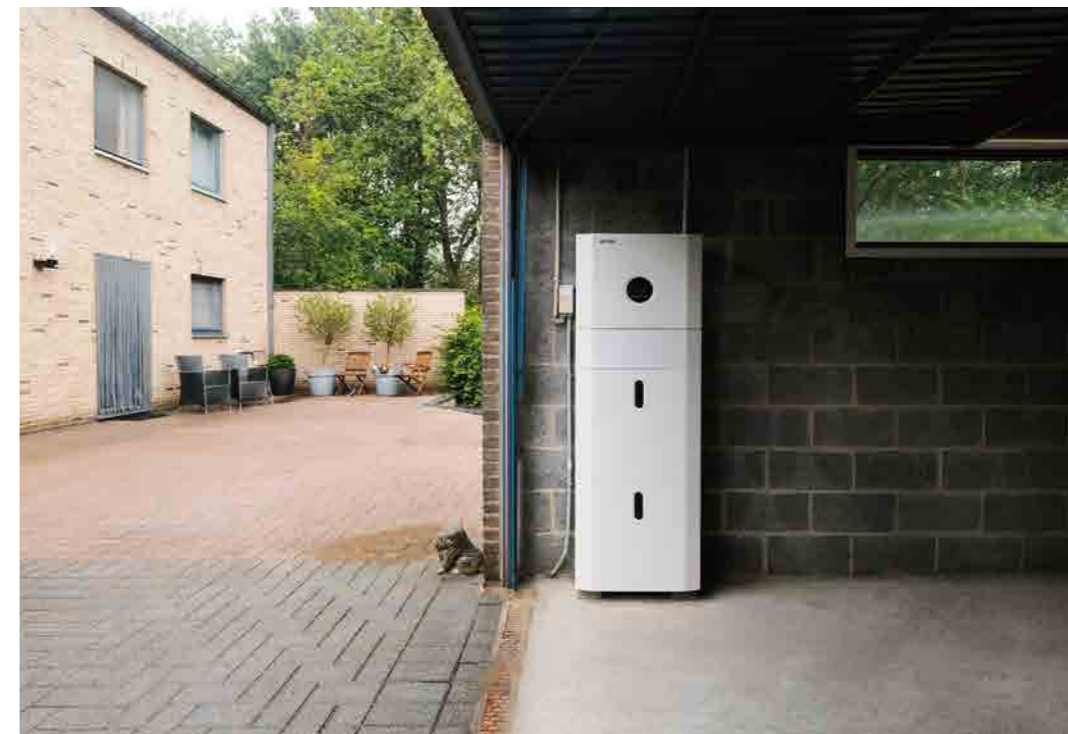
11 Residentieel ESS-project in België
